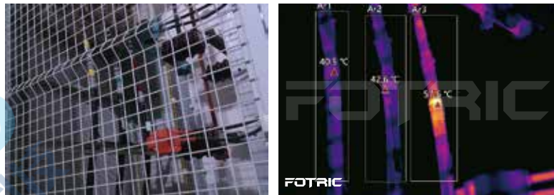
行车电气室监测
